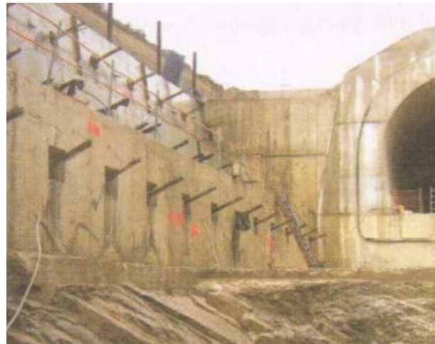
Donatılı beton kiriş
